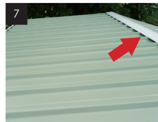
7: 屋根パネルを接合したビスの頭は、リッジビームを持ち上げて、ネジ頭をその下に配置します。表から見るとリッジビームの下に入ります。
